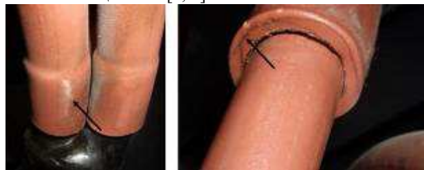
Рис. 1. Следы воздействия частичных разрядов на изоляцию кабельной линии.
