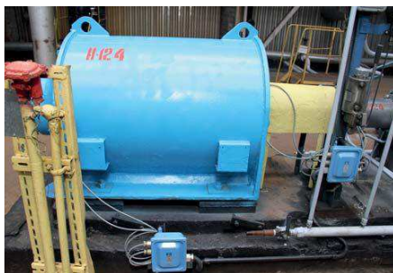
Насосный агрегат H-124, оснащенный системой «КОМПАКС»
